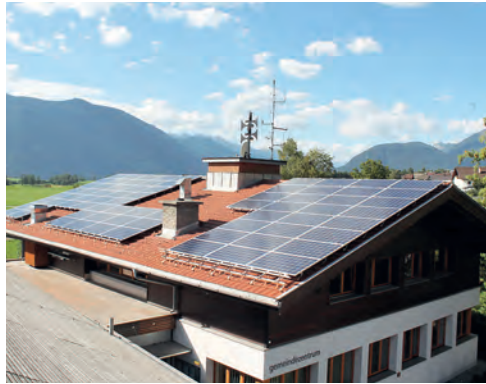
Photovoltaikanlage am Dach der Gemeinde
